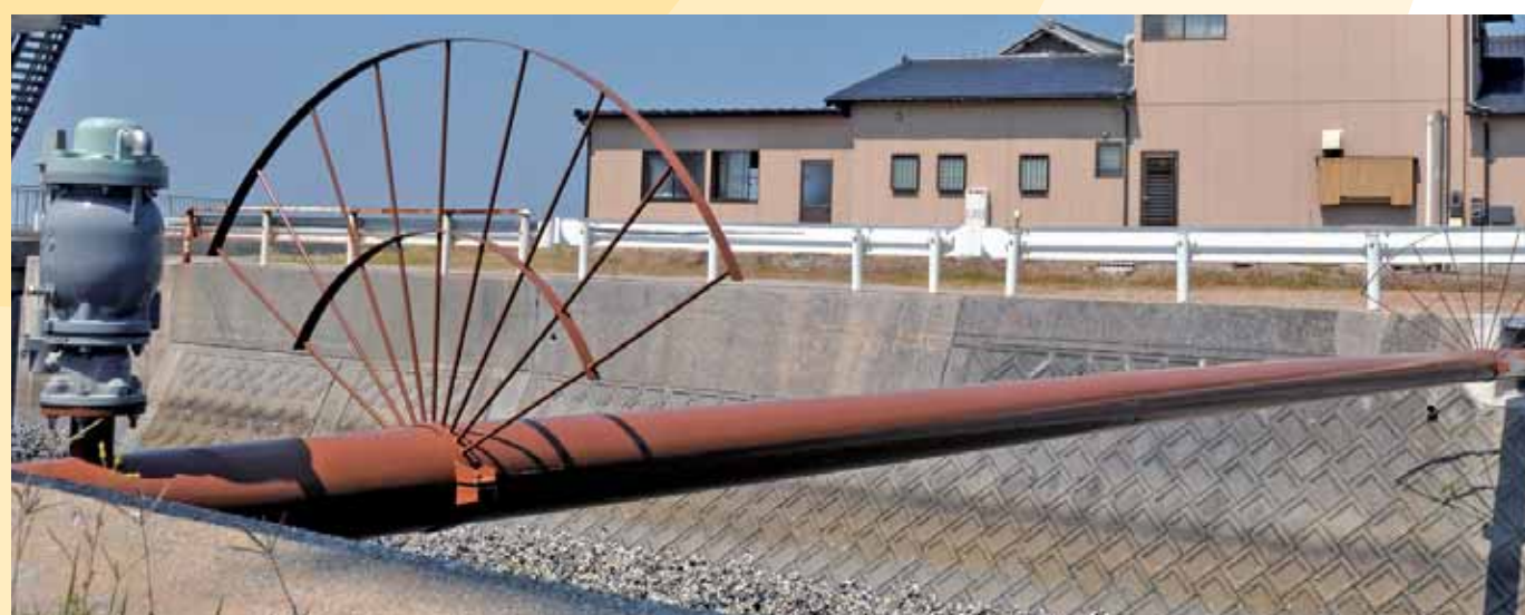
愛知県内 農業用水 パイプビーム形式水管橋塗覆装鋼管 200A
