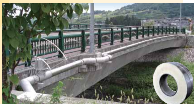
山梨県内 上水道 橋梁添架管形式水管橋 SUS304 150A / スパイラル管 SUS304 φ200
