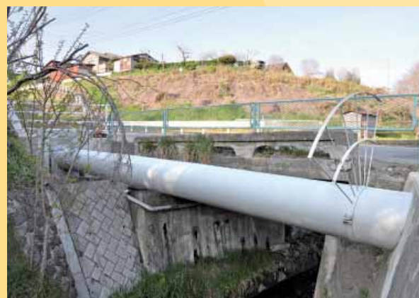
長野県内 雨水排水 パイプビーム形式水管橋塗覆装鋼管 600A
