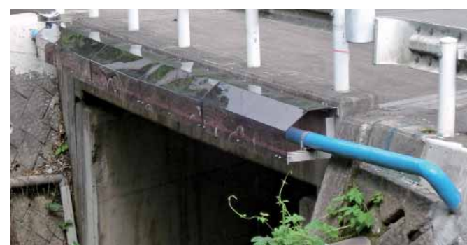
山梨県内 上水道 橋梁添架形式水管橋カバー付 SUS304 75A / FRP 防食保温 50mm
