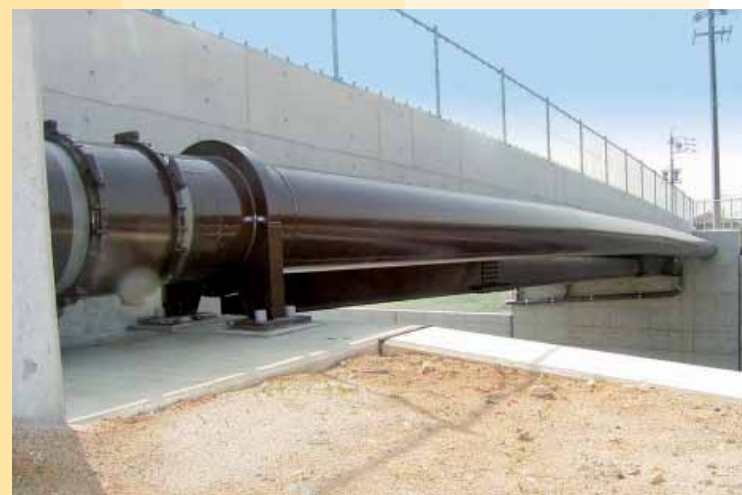
国土交通省岐阜県内 パイプビーム形式水管橋塗覆装鋼管 700A
