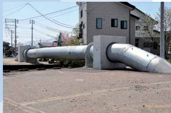
新潟県内 一般構造用鋼管亜鉛メッキ STK400 1100A 支間長 12.0m (NTT ケーブル挿入水管橋)
