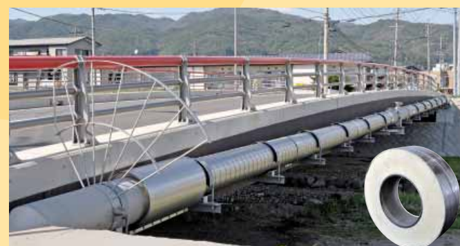
長野県内 上水道 橋梁添架管形式水管橋 SUS304 300A / 補強リブ付 SUS304 φ400
