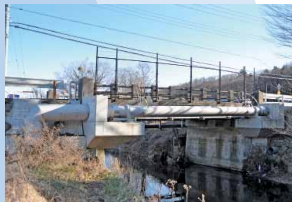
山梨県内 水道配水用ポリエチレン管 350A/SUS304 500A・SUS304 600A 支間長 8.2m
