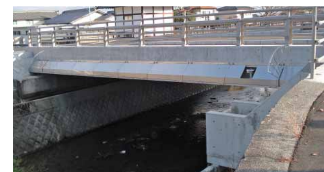
山梨県内 上水道 橋梁添架形式水管橋 化粧カバー付 SUS304 100A
